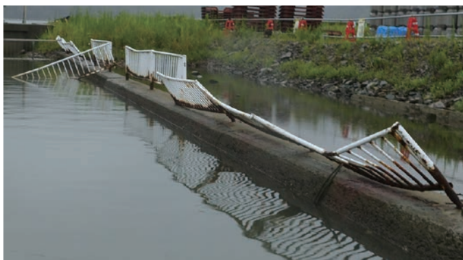
津波で折れ曲がったガードレール
