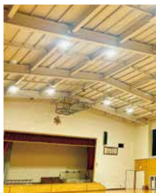
消費電力を約73%削減した地区体育館LED照明
